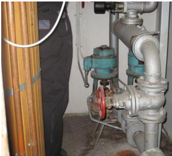
Utstyr i varmesentralen på Røra skole.
