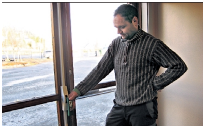
PANIKKBESLAG: Kjell Sundfær viser panikkbeslag som er montert på rømningsveger ved Utøy skole.
