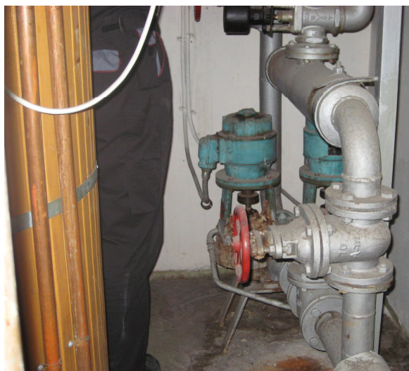
Utstyr i varmesentralen på Røra skole.
