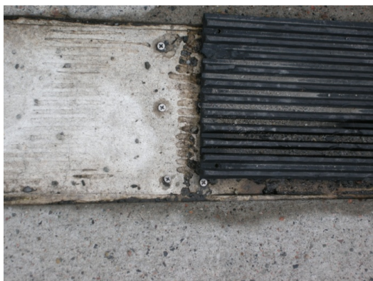
Figur: Skadd ledelinje i betongdekke
