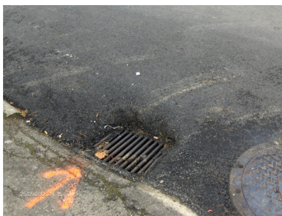
Figur: Manglende heving av sluktopp ved asfaltering kan gi nivåsprang.
