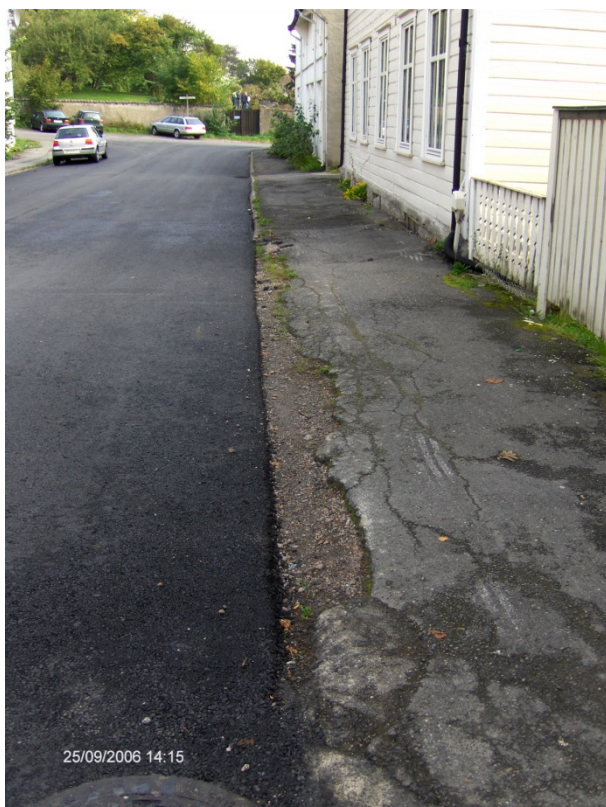
Figur: Manglende prioritering av gående ved dekkelegging.
