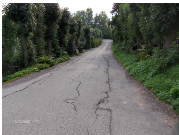
Figur: langsgående sprekker i asfaltdekke
