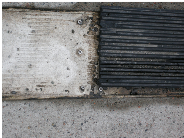
Figur: Skadd ledelinje i betongdekke
