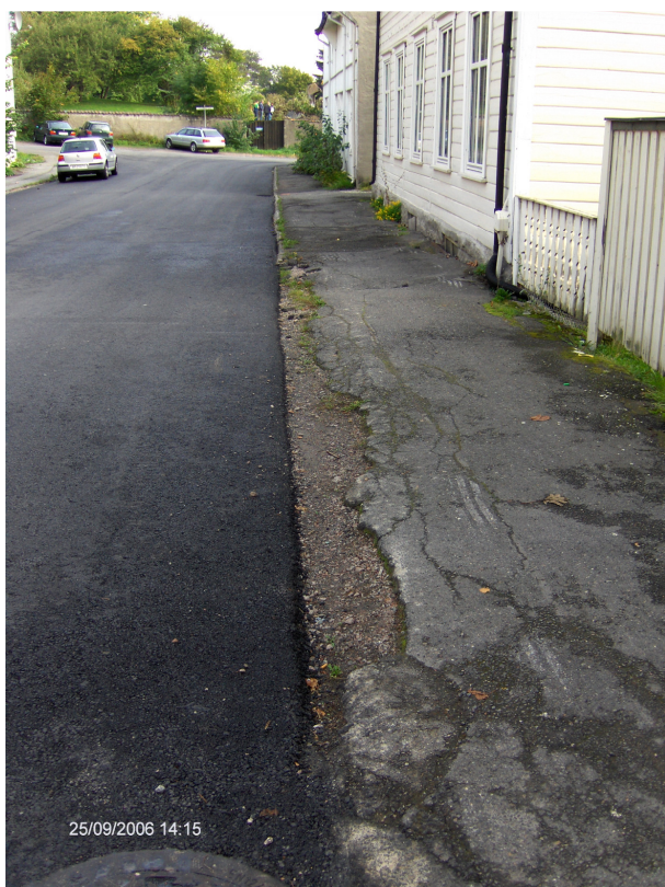
Figur: Manglende prioritering av gående ved dekkelegging.
