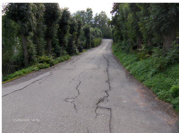
Figur: langsgående sprekker i asfaltdekke
